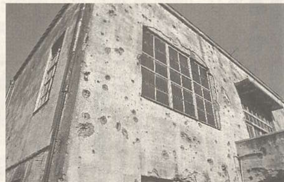
米軍機の弾痕が残る旧日立航空機立川工場変電所跡＝東京都東大和市で(安島太佳由さん提供)
